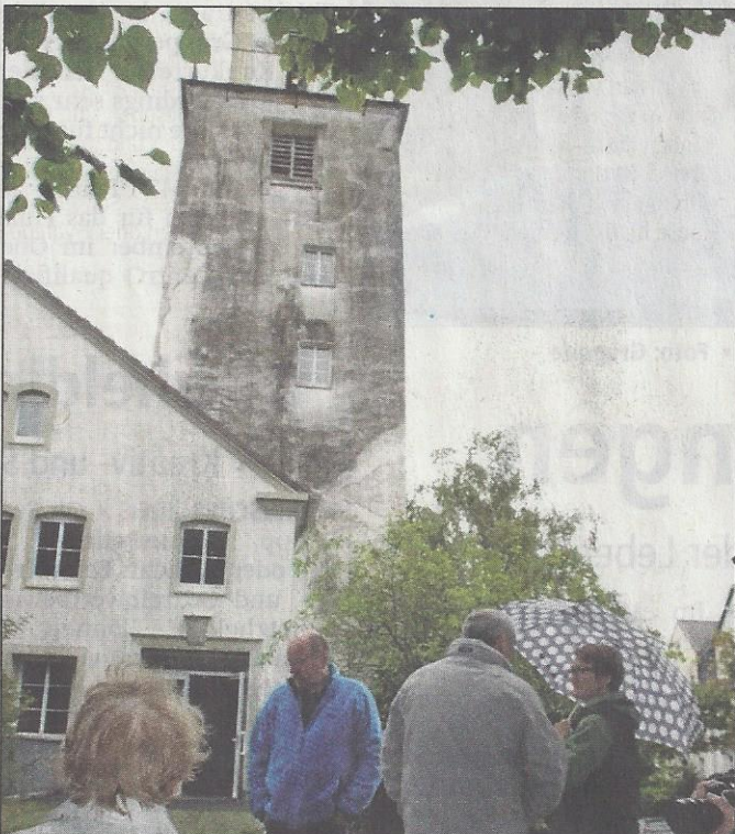
Aus dieser Perspektive ist klar zu erkennen, wie marode der alte Kirchturm ist.
